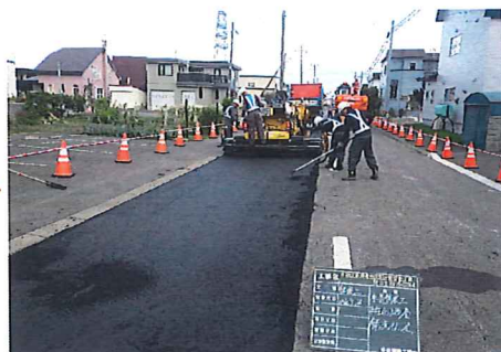
7、全ての水道管工事が完了した後、舗装の本復旧を行います。
