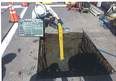
1、工事に先立ち、埋設されているガス管・水道管などの位置を確認します。(試験掘削)
