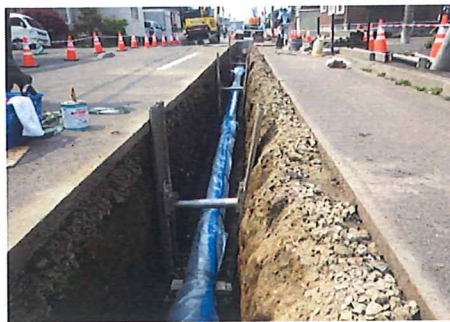
2、試験掘削で埋設可能な位置を特定した後、新しい水道管(本管)を埋設していきます。
