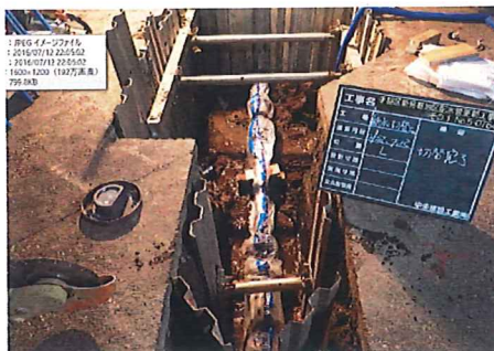
5、給水管つなぎかえが終わったら、古い管から新しい管に水の流れを切り替えていきます。
