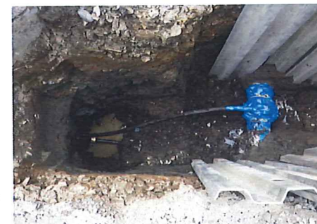
4、本管埋設完了後、各お宅の給水管を新しい水道管につなぎかえていきます。
